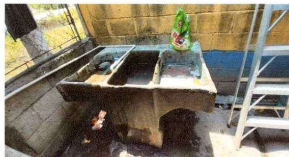
Foto 6: Sustrucción de pila de cemento por dos lavadero
